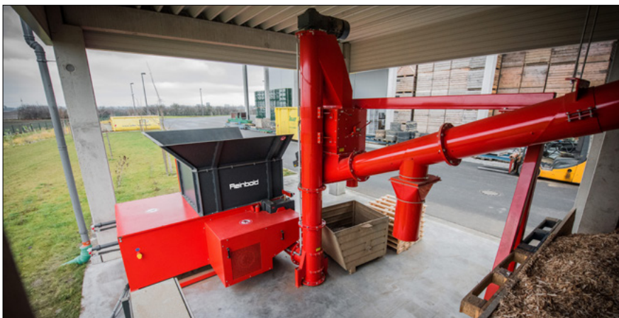
AZG mit Förderspirale und Trommelmagnet
