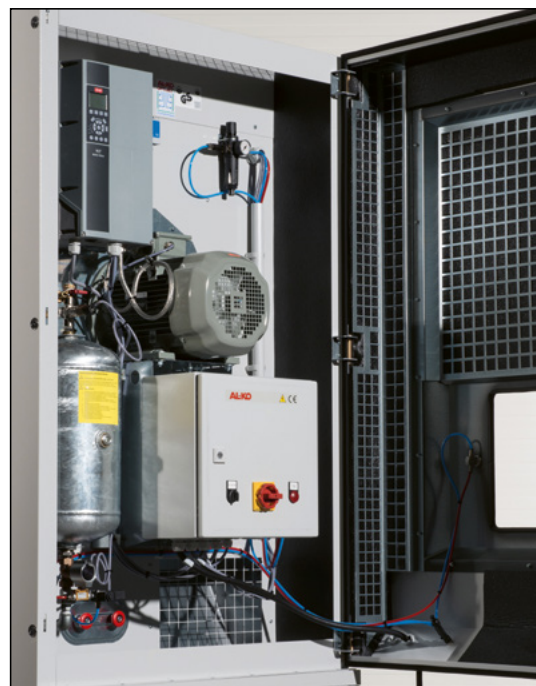
Steuerung mit FU und Löscheinrichtung
