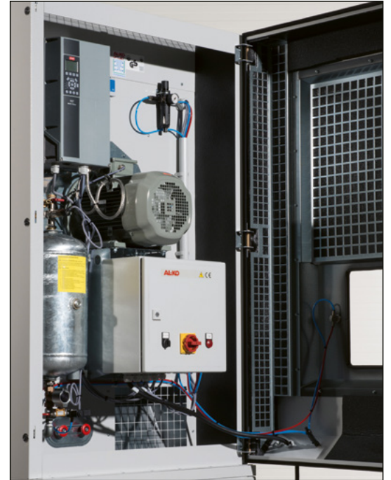
Steuerung mit FU und Löscheinrichtung
