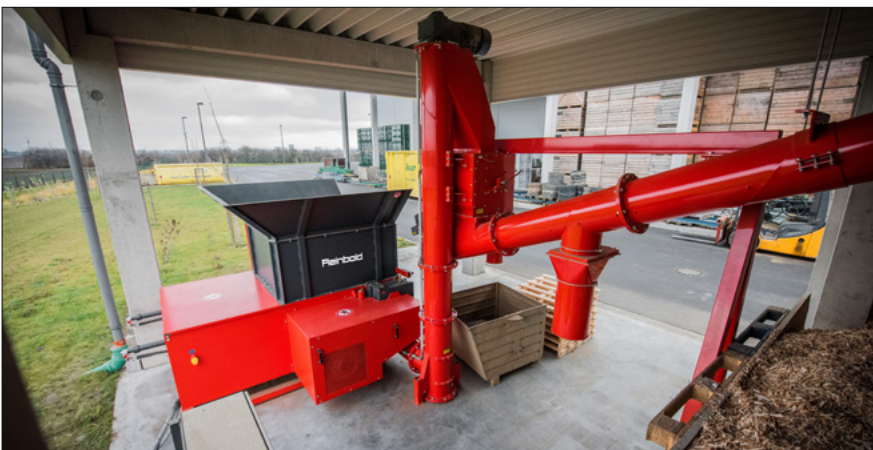
AZG mit Förderspirale und Trommelmagnet
