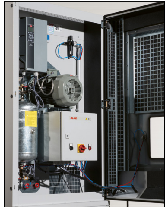
Steuerung mit FU und Löscheinrichtung
