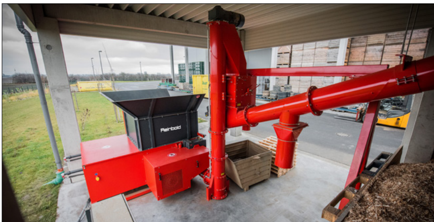
AZG mit Förderspirale und Trommelmagnet
