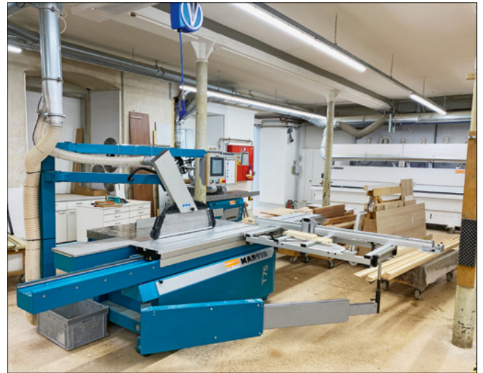
Die Maschine fertig montiert und installiert in der Werkstatt des Kunden
