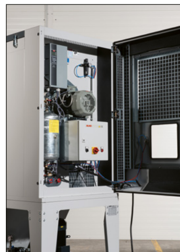
Steuerung mit FU und Löscheinrichtung
